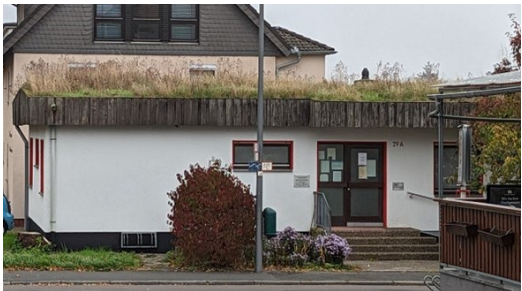
Extensiv gepflegte intensive Dachbegrünung | BPI (2022)
