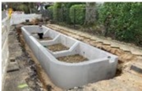
Regenwasserbehandlung und Versickerung Mendelssohnstraße | Meerbusch. (mall Umweltsysteme, 2023a)
