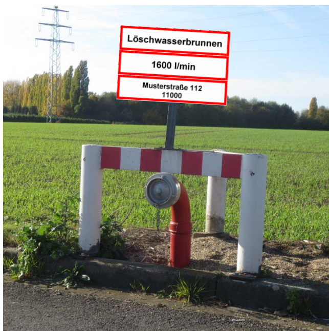
Saugstelle mit Anfahrtschutz
