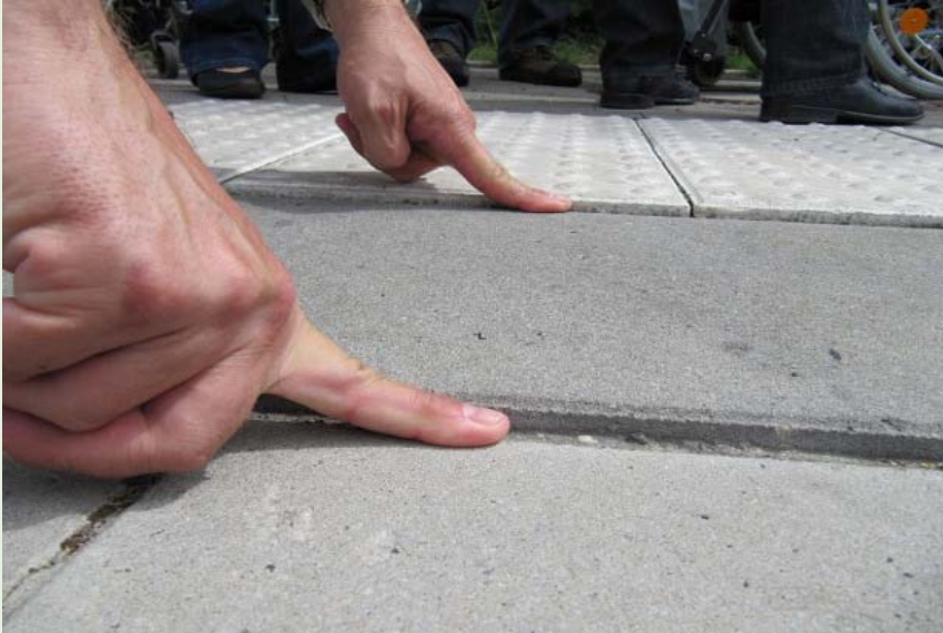
Bild 32: Einbau von Bodenindikatoren und Sonderbord mit zu großer Einbautoleranz
