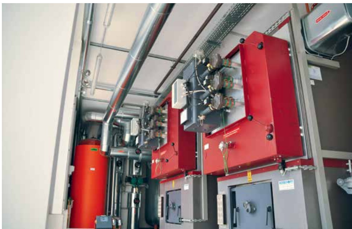
Moderne Heizanlagen auf Basis erneuerbarer Energien – wie hier eine Pelletheizung – können zum Klimaschutz beitragen.
