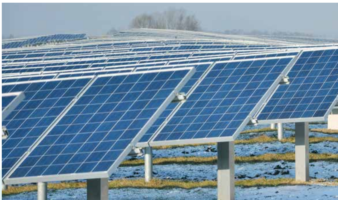
Die Sonnenenergie soll gemeinsam mit anderen regenerativen Energieträgern im zukünftigen Energiemix eine immer größere Rolle spielen. ©EnergieAgentur.NRW
